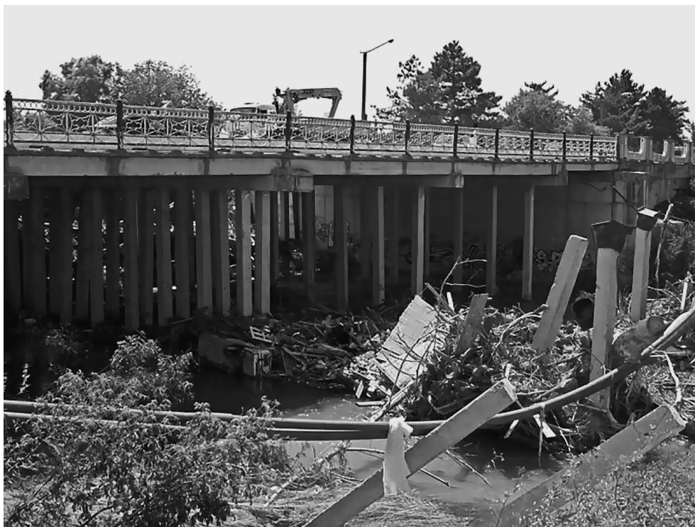
Рис. 5. Мост через р. Адагум после паводка.
